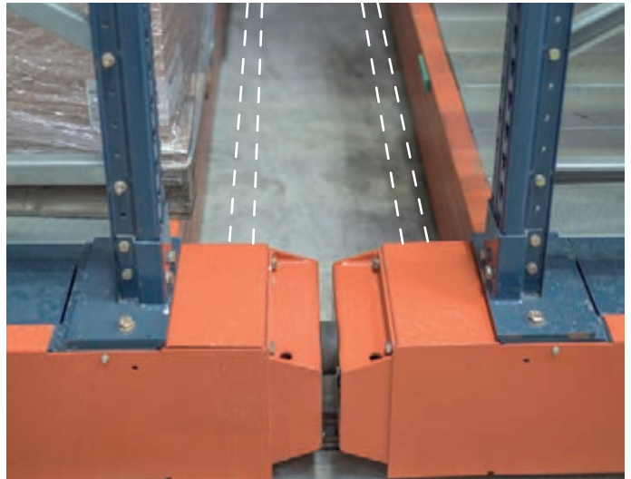
Barrera de seguridad interior
